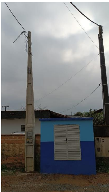
Figura 28 - Tipologia e fachada da entrada de energia e abrigo do gabinete.
