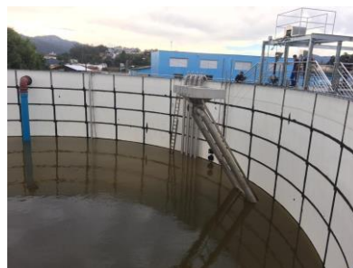
Figura 37 - Detalhe de unidade de Tratamento – SBR.
