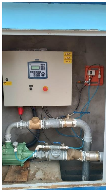
Figura 29 - Instrumentação hidráulica e elétrica do Booster.
