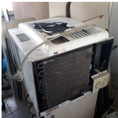
Item 28: Ar condicionado janelheiro Patrimônio: 1423
