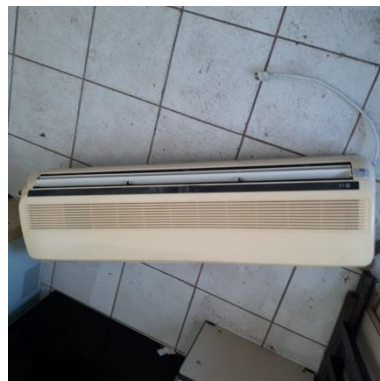
Item 30: Ar condicionado Split Patrimônio: 2008
