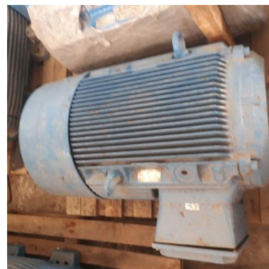
Item 12: Motor Weg 100 cv Patrimônio: Sem Patrimônio
