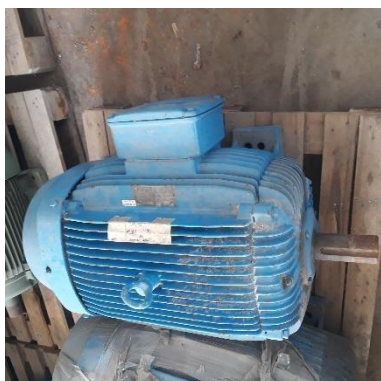
Item 13: Motor Weg 100 cv Patrimônio: Sem Patrimônio
