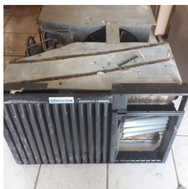
Item 32: Ar condicionado janelheiro Patrimônio: 473
