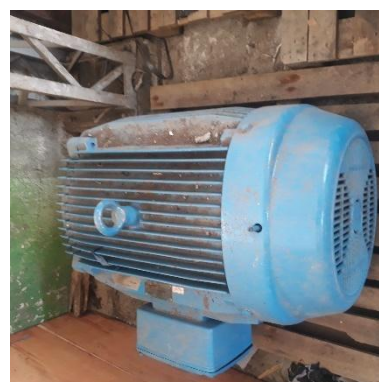
Item 03: Motor Weg 150 cv Patrimônio: Sem Patrimônio
