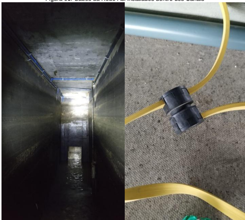
Figura 01: Cabos da Rede Asi instalados dentro dos Canais
