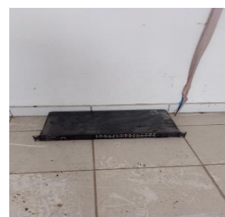
Switch TP-Link10/100 Sem Patrimônio
