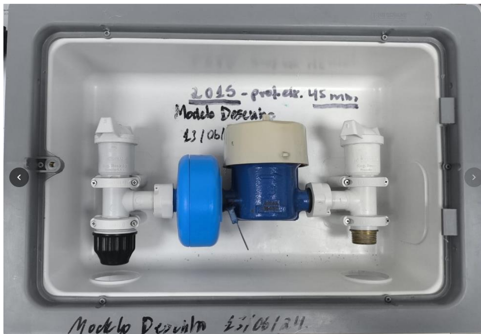
Figura 4 – Exemplo de montagem de conjunto filtro externo e hidrômetro volumétrico na Caixa Padrão.
